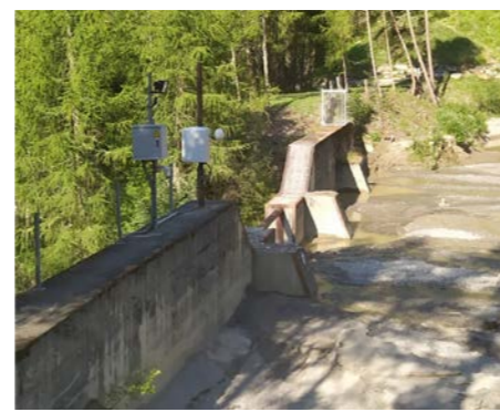
Abbildung 3: HF-Radar auf Retentionsbauwerk.
